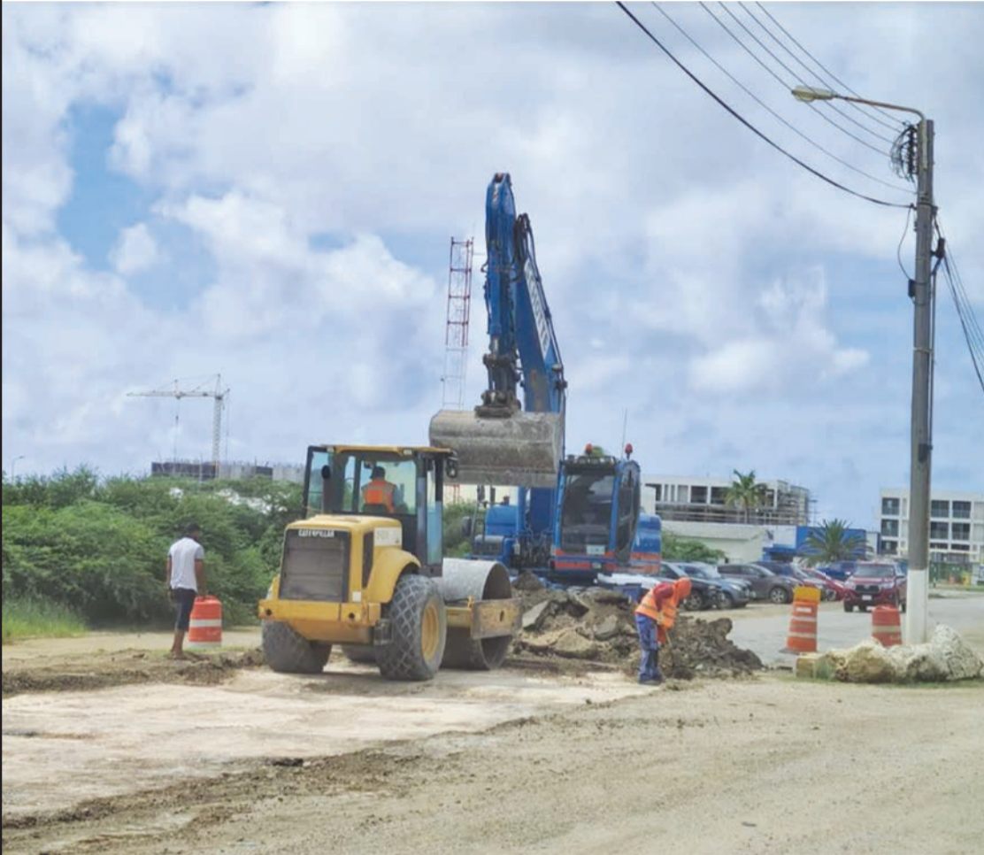
Tin basta esfuerso ta tumando lugá pa aliviá e situashon di kayanan di Boneiru. Basta buraku riba kaya debí na e yobidanan ku a asotá e isla. Un kaya ku ta den kondishon hopi deplorabel ya Kaya Amsterdam. Foto ta mustra kon ta kibra un pida kaya banda di Playa Trading pa basha asfalt nobo.
